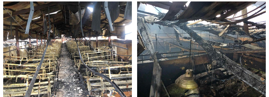
축사 전기화재 피해 사례
