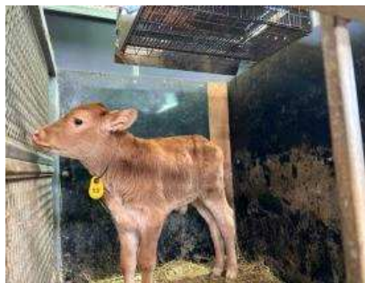
원적외선 보온등 설치
